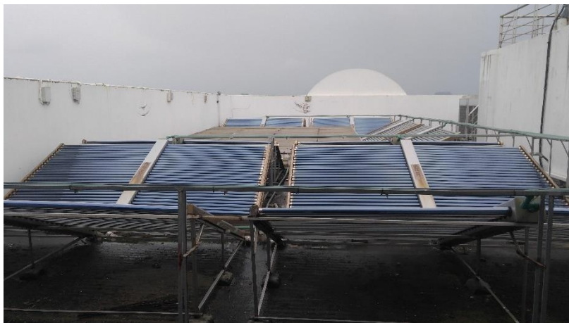
Hình 3 & 4: Hệ thống nước nóng năng lượng mặt trời và máy bơm tại khách sạn Moonlight
